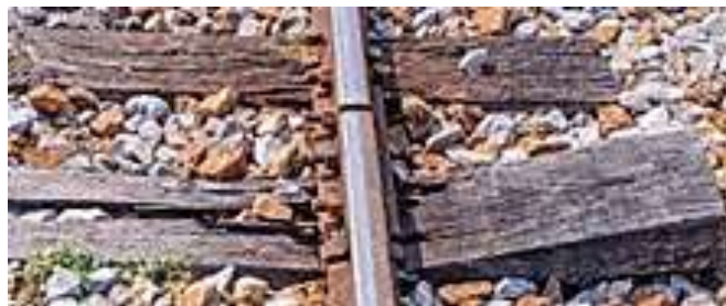
Şekil 2. Ahşap traversin çatlama ve kırılması
