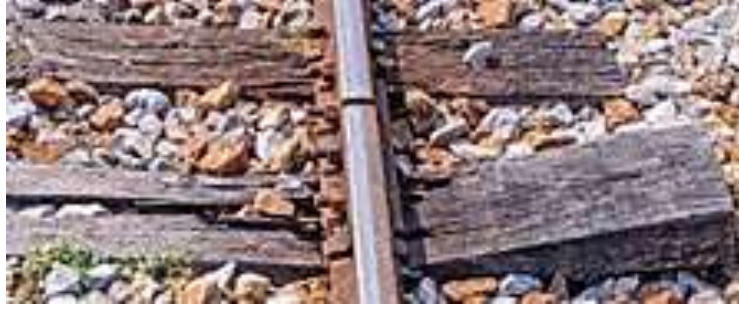
Şekil 2. Ahşap traversin çatlaması ve kırılması
