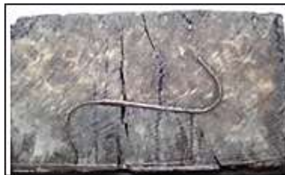
Şekil 8. Ahşap traverse "S" demiri takviyesi
