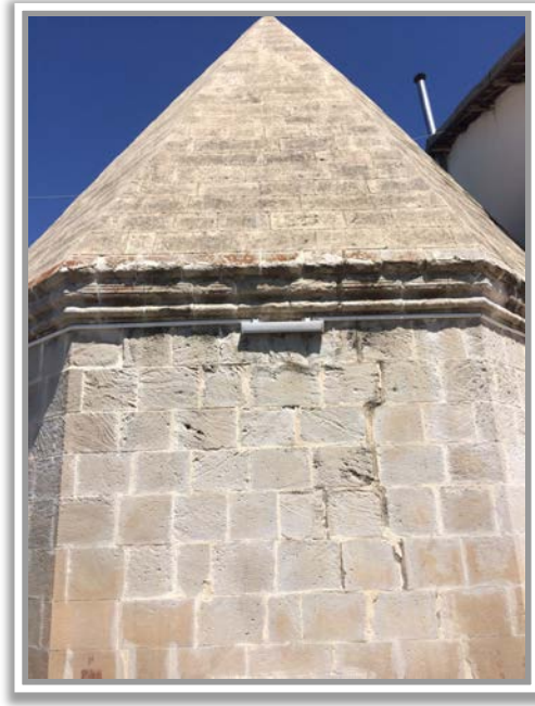
Fotoğraf 22: Güney Cephedeki Silmeler
