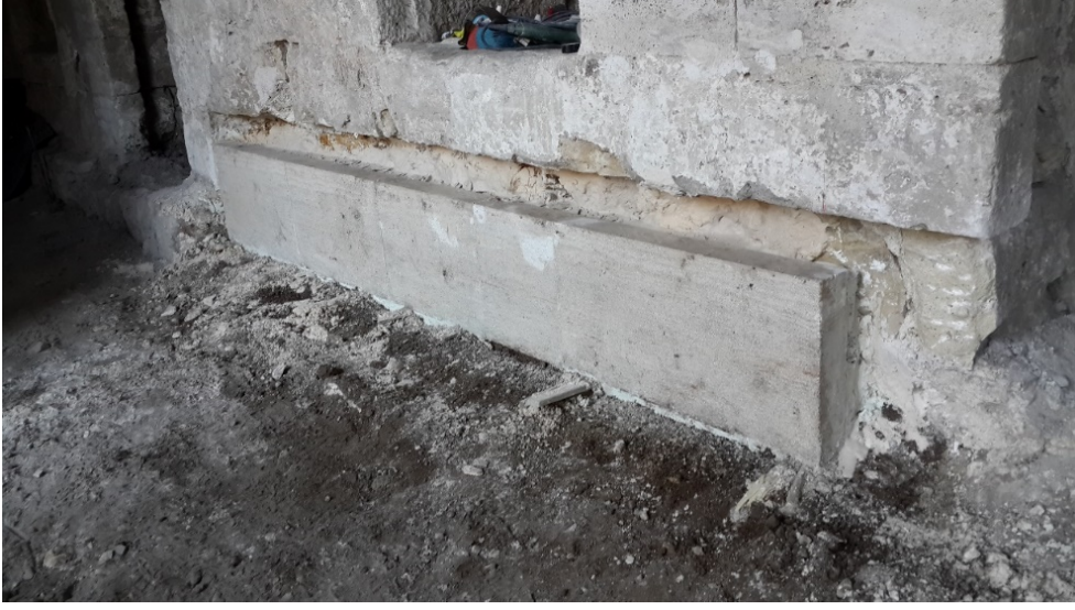
Fotoğraf 182: Yapının zemin kat güneydoğu revakı odaların iç avluya bakan yüzlerinde taş kaplama işlemleri
