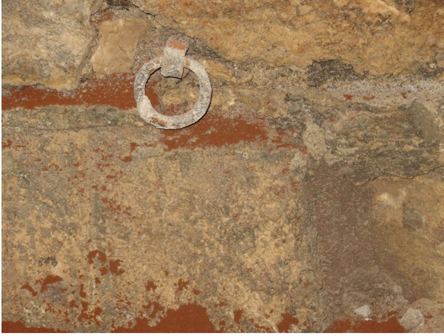
(Fotoğraf 146: Demir kancaların bulunduğu mahalde korunması)
