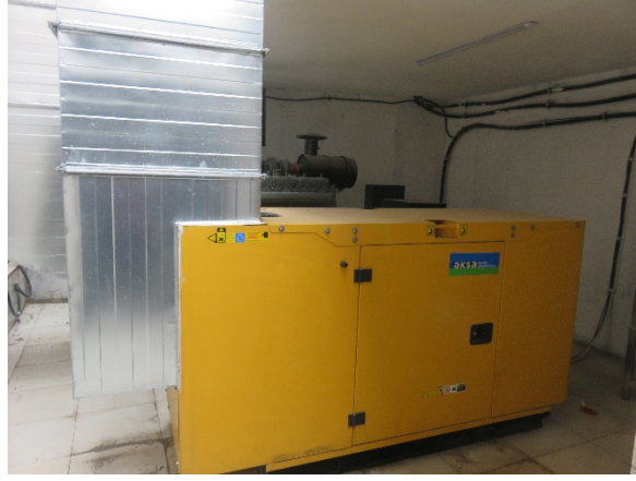
Fotoğraf 153: Hanın kuzeybatısına yapılan jeneratör odasındaki jeneratörler
