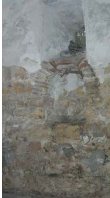
Fotoğraf 80: Zemin kat odalardan güneybatı duvarındaki pencere ve hemen altında yer alan tuğla kemerli niş
