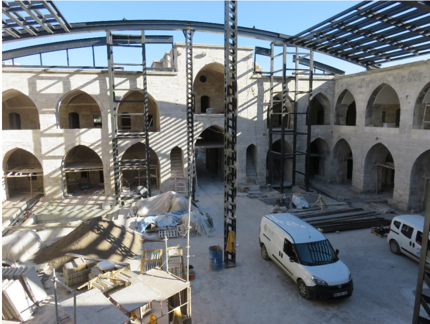
Fotoğraf 289: Behram Paşa Hanı açılır-kapanır çelik örtüsü
