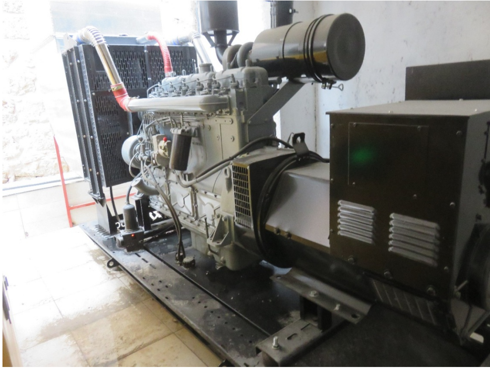
Fotoğraf 152: Hanın kuzeybatısına yapılan jeneratör odasındaki jeneratörler
