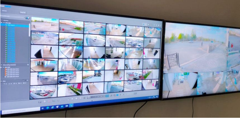
Şekil 2.1.4. Bina kamera sistemi
