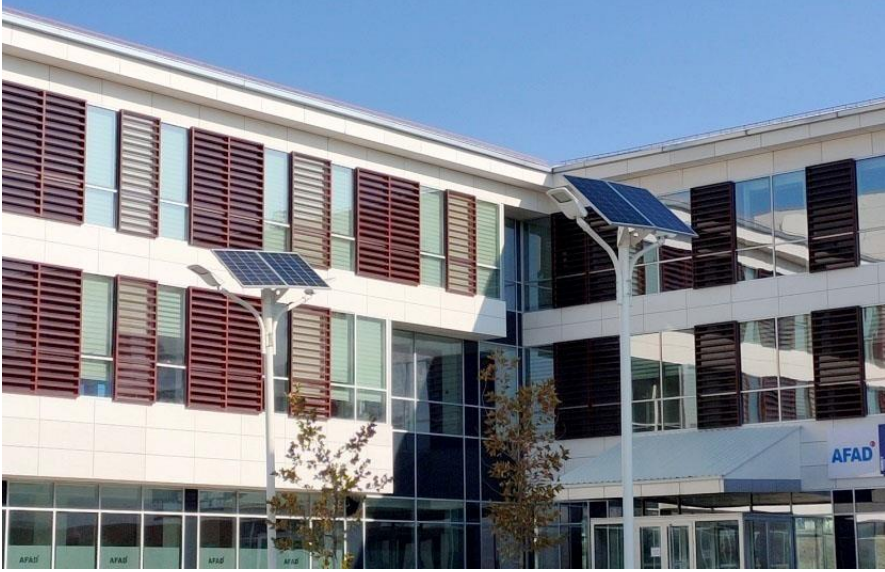
Şekil 2.1.6. Güneş enerji panelli aydınlatma direkleri
