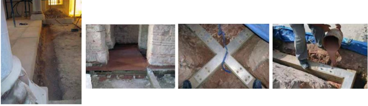
Şekil 3. I. Mahmut Kütüphanesinin zemin kat sütun altlarında yapılan ahşap hatıl sistemi ve birleşim detayları
