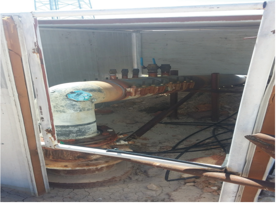
Şekil 4: Kozaklı merkezi ısıtsa sistemi reenjeksiyon kuyusu
