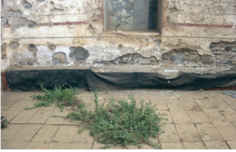
Resim 3. Çatı ve tabanda kullanılması gerektiği gibi kullanılmayan geotekstil (Dikilitaş, 2021, s. 44)
