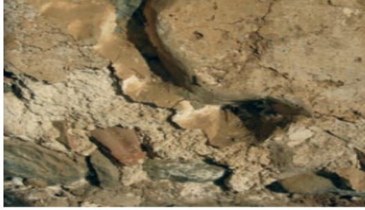
Resim 8. Onarımı gerçekleştirilen duvarlardaki su ve tuz hareketi neticesi oluşan tahribat (Dikilitaş, 2021, s. 46).
