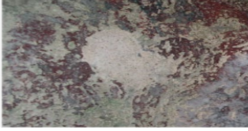
Resim 7. Duvar resimli yüzeyde tekrarlanan tuz kristalleşmesi (Dikilitaş, 2021, s. 46).
