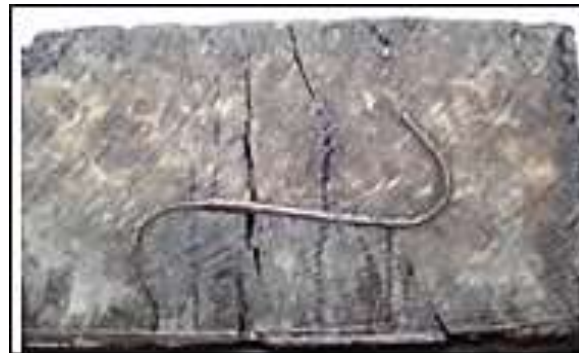
Şekil 8. Ahşap traverse "S" demiri takviyesi
