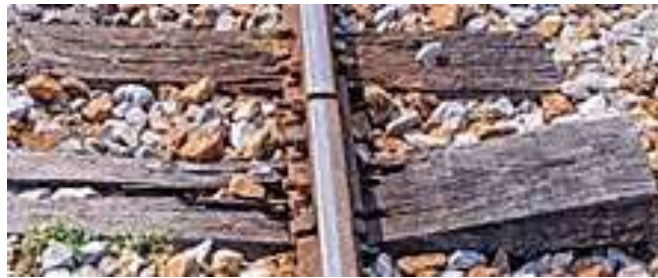
Şekil 2. Ahşap traversin çatlama ve kırılması
